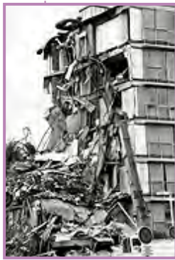
Immeuble les Contemporains, Elancourt. (détruit). 500 logts.
